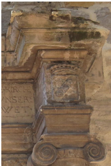
Portal Pauluskirche (Ausschnitt): Vor der Sanierung (1.9.2018).
